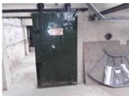
Panels inside Fire Door
